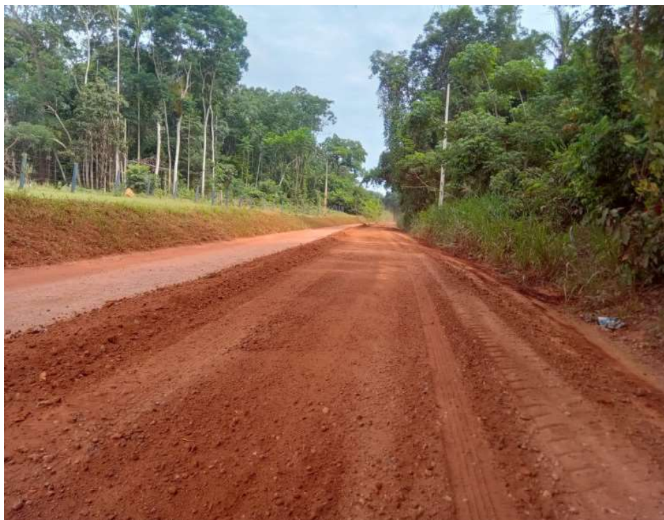
Foram realizados serviços de limpeza lateral, raspagem e terraplanagem para tapar os buracos
