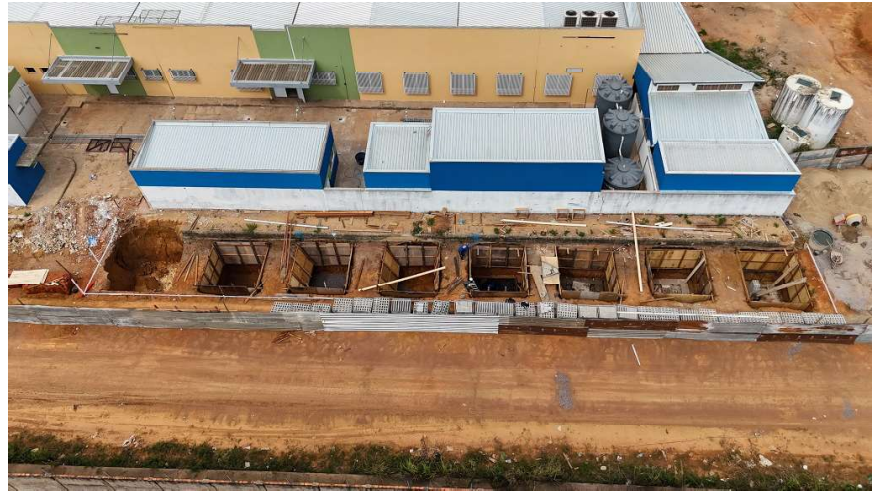
construção do Hospital Regional de Guajará-Mirim está em ritmo acelerado, acompanhado pela deputada Dra. Taíssa
