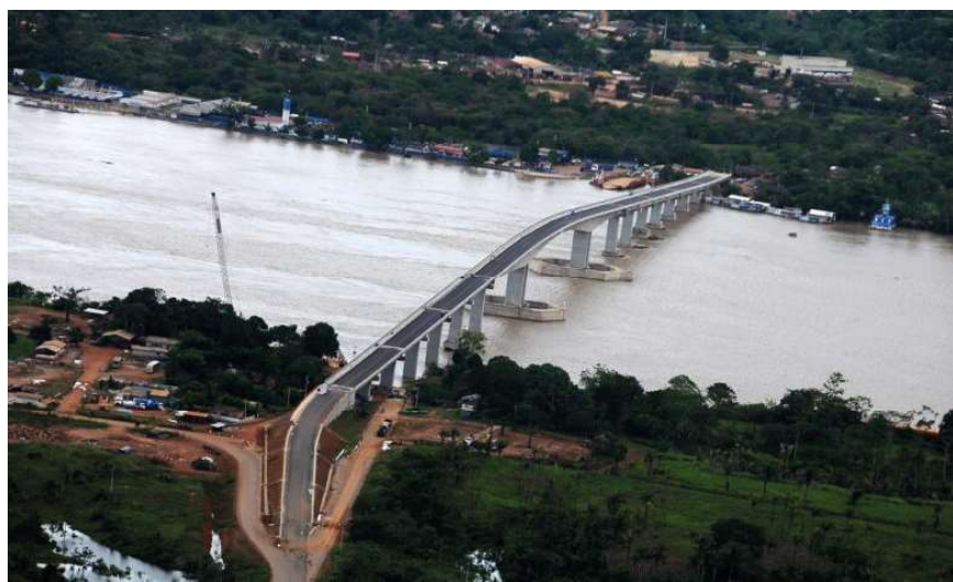
Ponte precisa de reparos mas não oferece riscos à população, disseram engenheiros do DNIT
